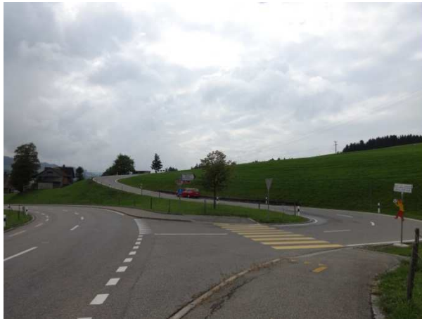
Bild 14: mit wenig Mitteln zu behebbende Schwachstelle im Langsamverkehr an der Strecke Waldstatt – Schönengrund: absenken der Randsteine und Änderung der Markierung für Radfahrende.
